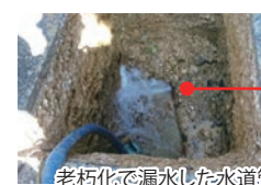
老朽化で漏水した水道管
