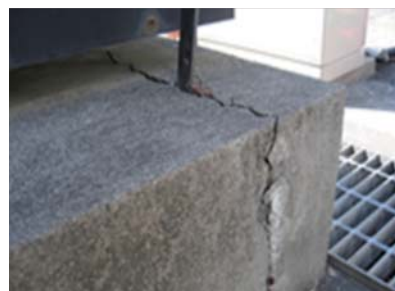
看板基礎のひび割れ
