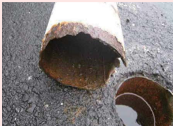
ポールの根腐れによる倒壊
