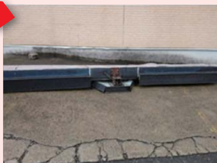
落下した欄間看板
