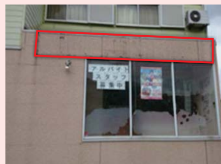
落下した後の壁面
