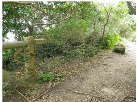
写真 82 安全柵未整備区間
