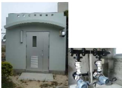
6. 仲間増圧ポンプ所
