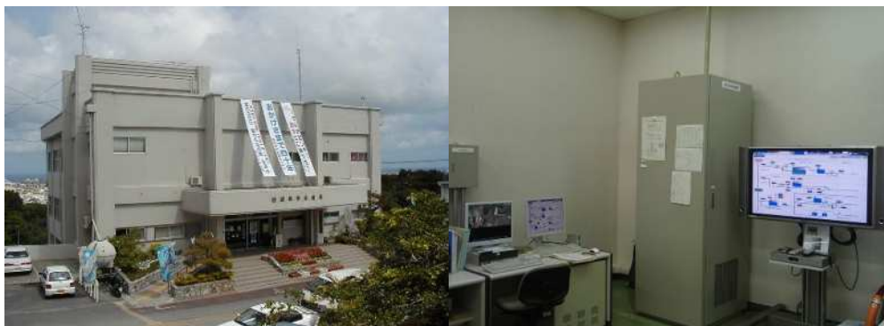
7. 中央監視室 (水道部庁舎内)
