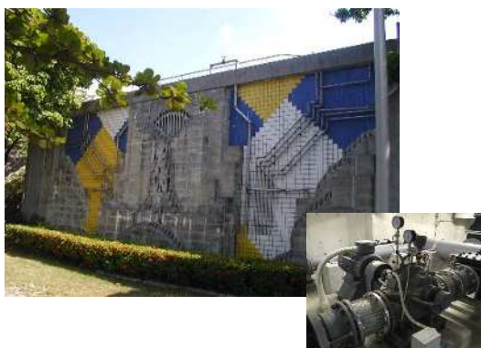
4. 浦仲中継ポンプ施設
