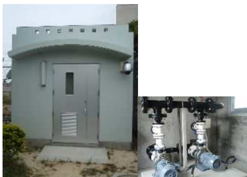
6. 仲間増圧ポンプ所
