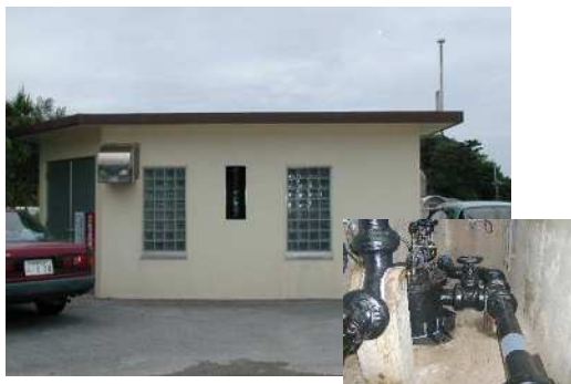
5. 前田増圧ポンプ施設
